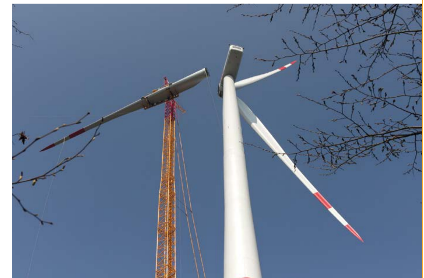
Während noch vor wenigen Jahren die so genannte Sternmontage üblich war, werden die Rotorblätter an Standorten im Wald mittlerweile einzeln mit dem Kran nach oben gezogen und an der Nabe montiert. So kann die Rodungsfläche minimiert werden.
