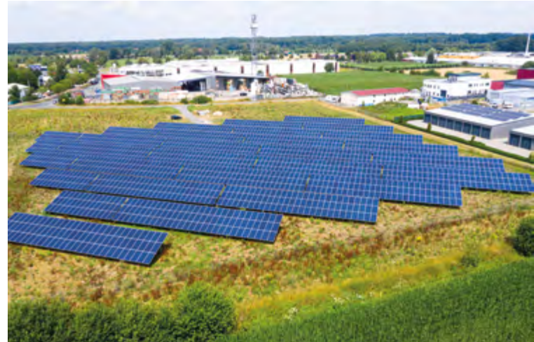
Der Solarpark in Dülmen, Nordrhein-Westfalen liegt in einem Gewerbegebiet und bringt mit 2.262 Modulen eine Anlagenleistung von 750 kWp.
