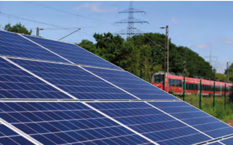
Die PV-Anlage in Salmtal im rheinland-pfälzischen Landkreis Bernkastel-Wittlich liegt innerhalb des 110 breiten Randstreifens einer Bahntrasse und erhält daher Vergütung gemäß EEG.
