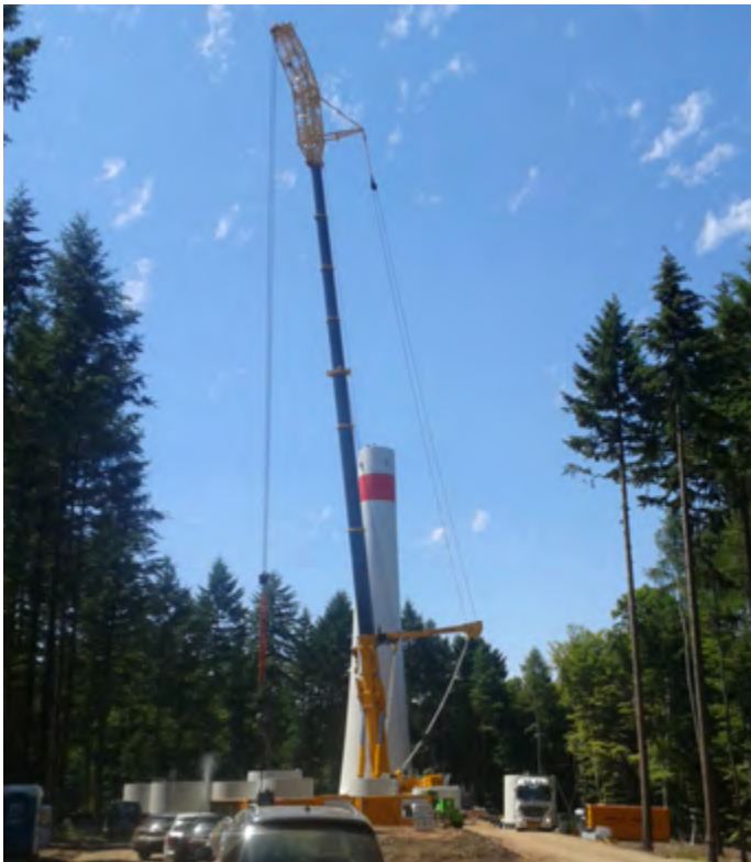
Der Turm einer der Anlagen des Windparks Jungenwald wird errichtet; links im Bild die Betonsegmente des Turms.
