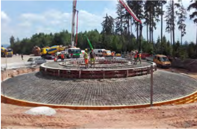
Nachdem die Bewehrung des Fundaments fertig ist, wird die Konstruktion mit Beton ausgegossen.
