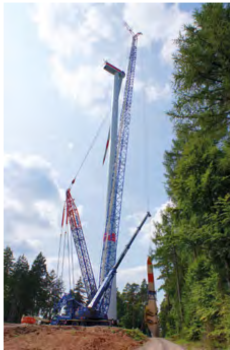
Mit den Stahlrohrsegmenten erreicht der Turm seine Höhe von 159,2 Metern. Anschließend wurde das Maschinenhaus aufgesetzt.
