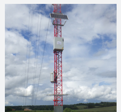
Panneau solaire Coffret data logger Enregistre et transmet les données mesurées
