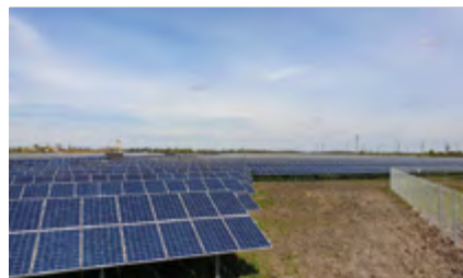
Püspökladány, Hungria, 6,5 MWp, instalación en campo libre (2020)
