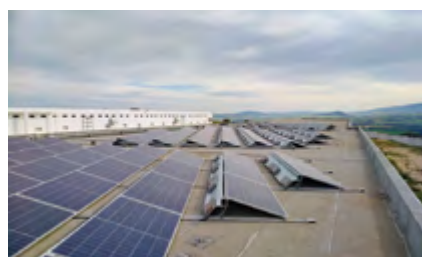
Poulina, Túnez, 1,5 MWp, instalación en tejado para autoconsumo industrial (2020)
