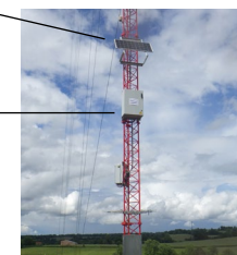
Panneau solaire Coffret data logger Enregistre et transmet les données mesurées
