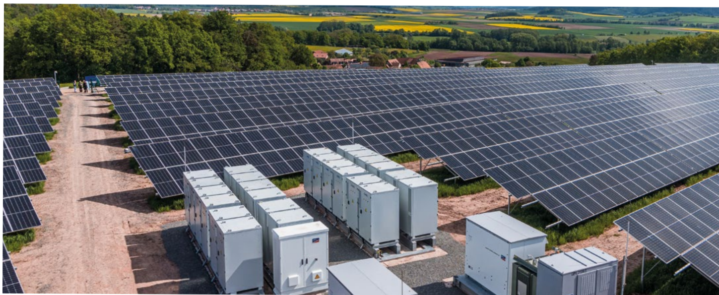
Das bayerische PV-Batterie-Hybridprojekt Leutershausen wurde im Mai feierlich eingeweiht.
